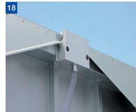
フロント雨水受け
