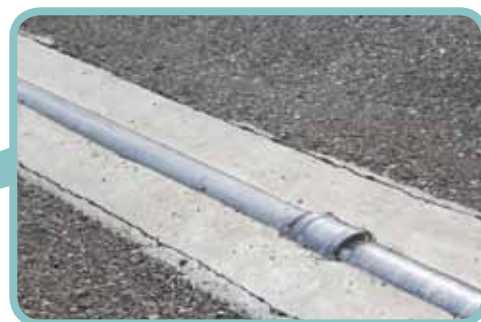
トラックヤードに設置された融雪装置
