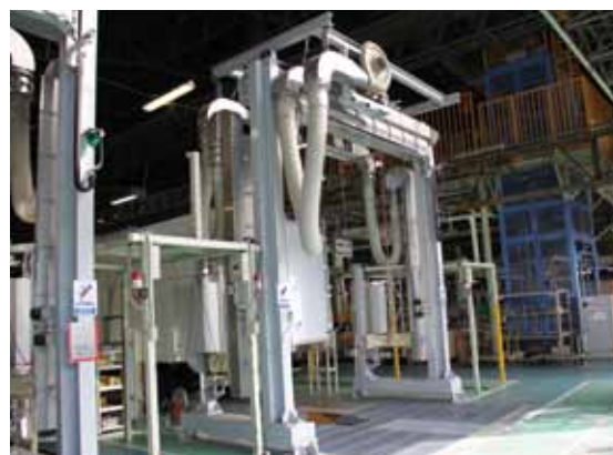
艤装工程に設置された水切り装置
