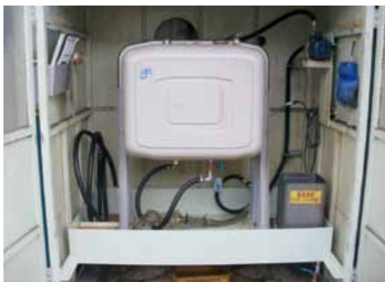
軽油タンク破損時の軽油漏洩を防ぐため、タンク内の軽油全量を受けられるオイルパンを設置しました。
