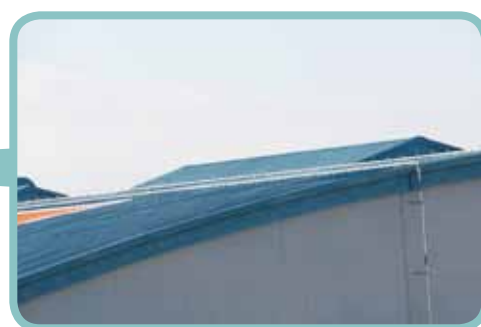
ウイング組立工場屋根に設置された融雪装置
