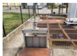
緊急遮断用の水門
